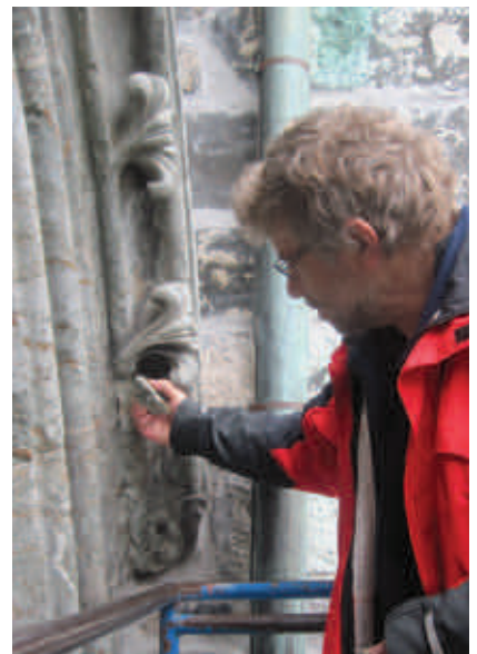
Klebersteinsarbeidene blir svært omfattende og dreier seg om 30-40 årsverk frem til 2025. Sprekker, løse biter, forvitring. Her RIB Knut Georg Nilsen.
