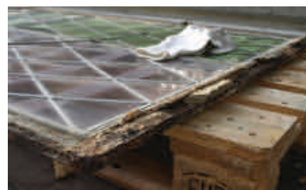
Problemområdet på mange av vinduene: rusten bunnkarm.
