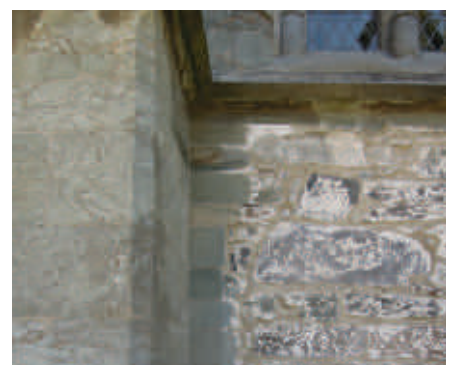
Det er fremdeles rester etter utvendig kalkpuss flere steder på Domkirken.
