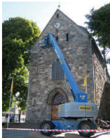
Vår anbefaling er å begynne med klebersteinsarbeidene, først av alt på vestfasaden. Her er mange løse biter med stein som kan være en risiko ifht personsikkerhet.
