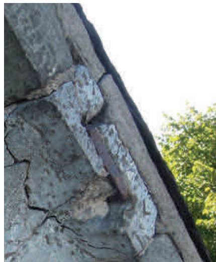
Overgang mellom kleber og skifertaket er tettet igjen med sementmørtel og ulike typer moderne, elastiske masser. Dette må fjernes. Kobberbeslag i denne overgangen bør vurderes.
