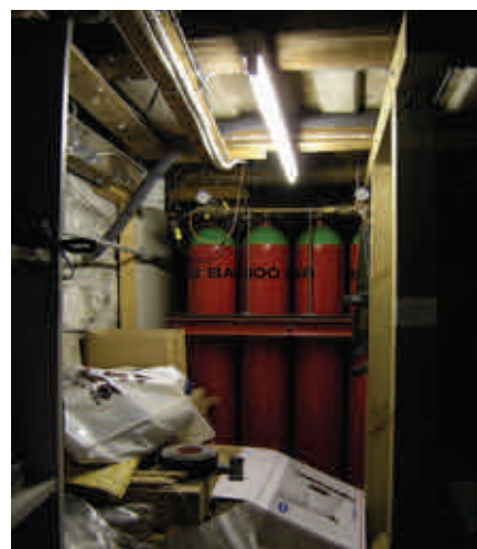
Flaskesentralen til inergengassanlegget i kjelleren
