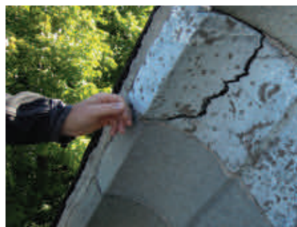
De omfattende sprekkdannelsene i vestgavlen må sikres raskt.
