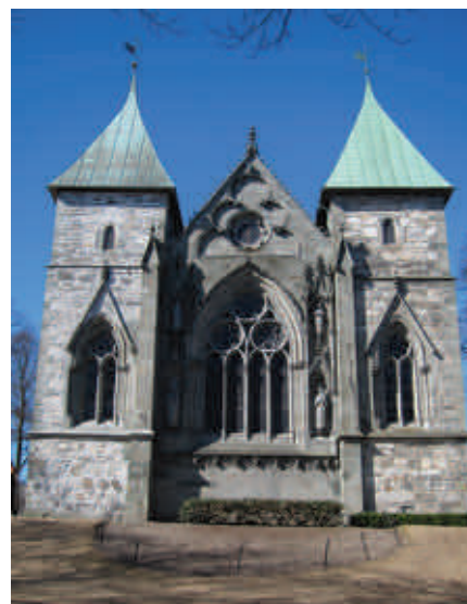
Domkirkens østfasade etter at sørtårnet til venstre ble restaurert. All sement, utvendig og innvendig, ble erstattet med tradisjonell kalkmørtel. Fremdeles står det noe fukt i de tykke steinveggene.
