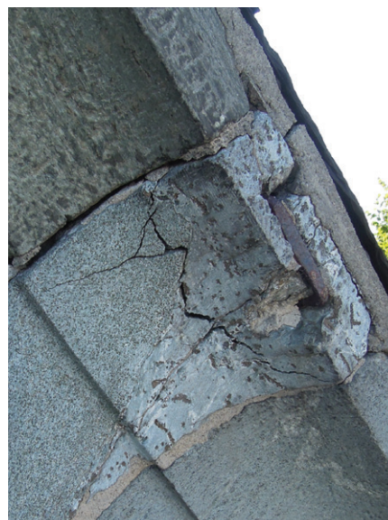
Rustet jern i kleber. Alvorlige sprekkdannelser i vestgavlen.
