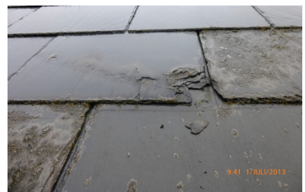
Skiferen er til dels løvtynn. Det er en del løse steiner, delaminering og stein med kantskader.
